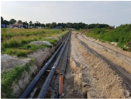
driebuizenleidingsysteem in de grond
